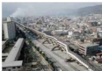
高速道路の崩壊
